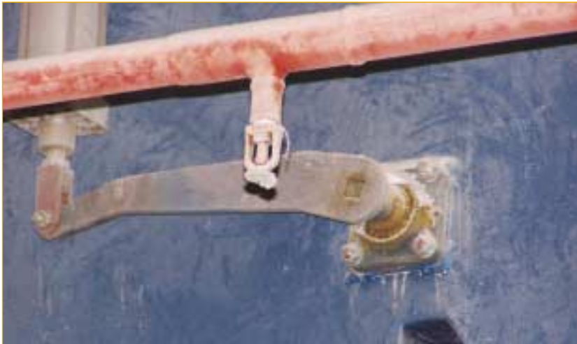
SLIKA 5 Primer poškodovane in umazane sprinklerske glave (slab nadzor nad sistemom aktivne požarne zaščite)
