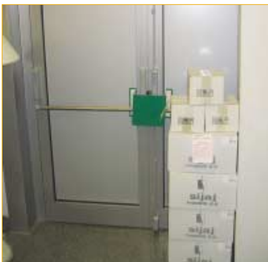
SLIKA 3 Založena in z verigo in obešanko zaklenjena vrata na evakuacijski poti
