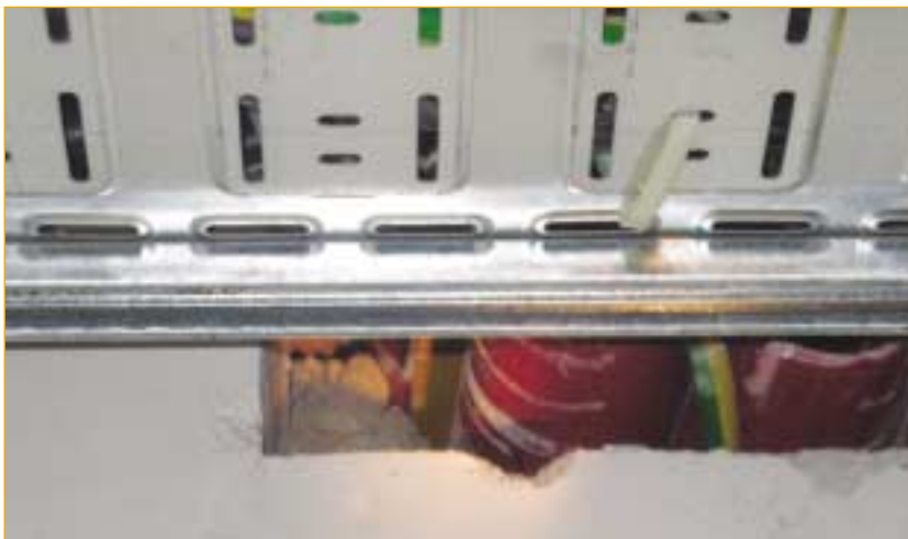
SLIKA 2 Slabo izveden prehod električnih instalacij na mejah požarnega sektorja
