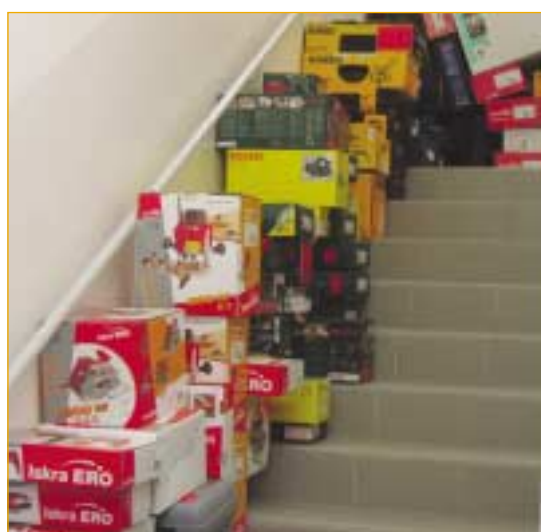
SLIKA 4 Založeno stopnišče na evakuacijski poti
