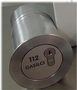
Slika 28: Cevasti trezor za hrambo ključev, ki ga odpira gasilski ključ
