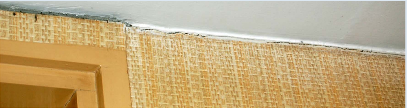
Slika 8: Razpoka na stiku stene in stropa zaradi čezmernih povosov preklade pod steno.
