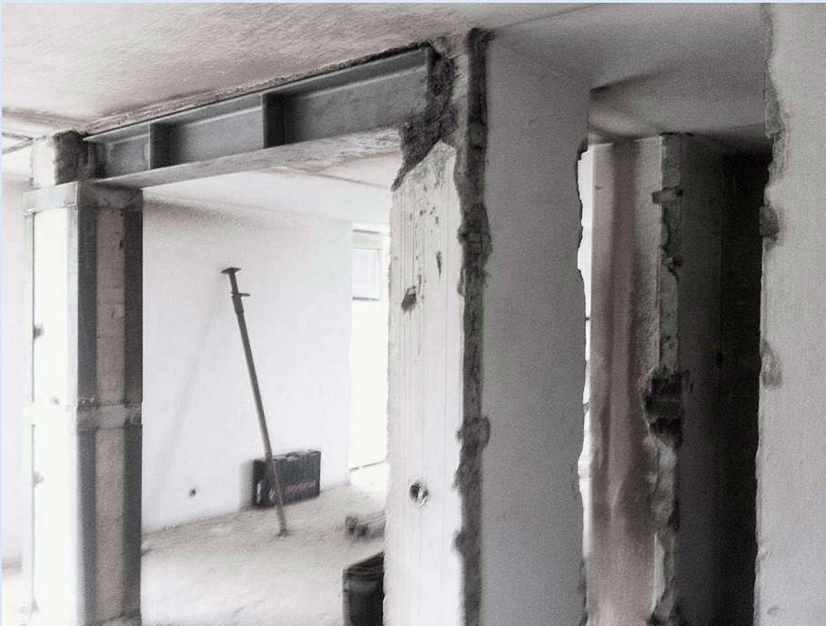
Slika 9: Odstranitev daljšega dela zidu je povečala obremenitve v preostanku zidu prek dopustnih obremenitev.
