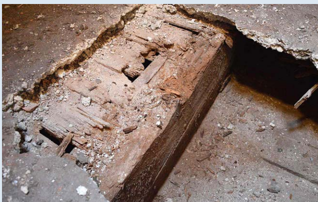
Slika 21: Propadanje poveznika zaradi neustrezne izvedbe zračnika.
