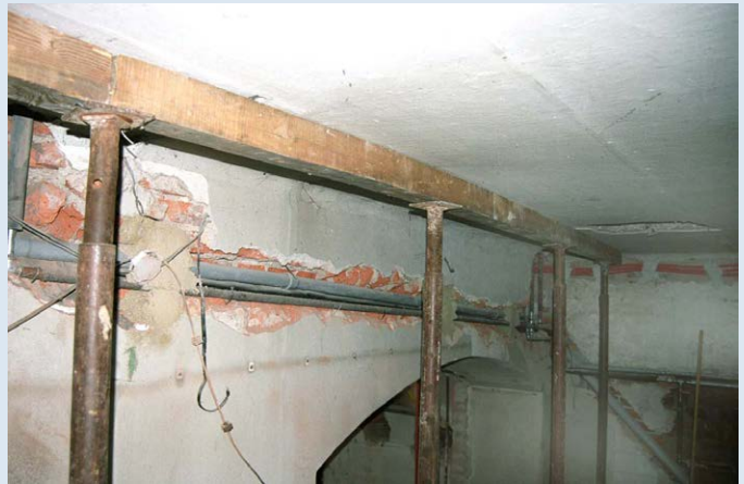
Slika 4: Nedovoljena izvedba utorov v ločnem nosilcu.
