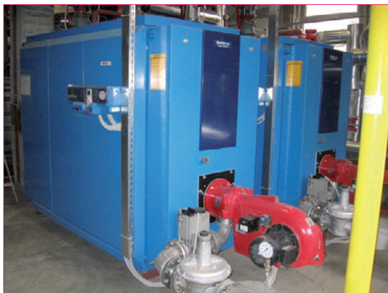
SLIKA 7: Plinska kotla 2 x 1,32 MW t .
