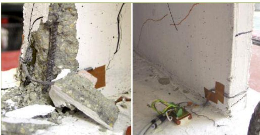
SLIKA 7 Slabše obnašanje vogala, ki ni bil objet s stremeni po evropskih predpisih (slika levo; armaturni detajl 2 na sliki 6)
