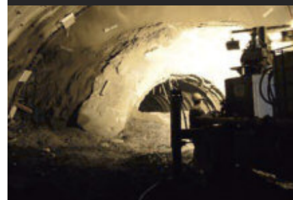
SLIKA 6 > Pričaz gradnje kalote kaverne na odseku, kjer je bil izdelan raziskovalni rov (Črepišek M. 2006).
