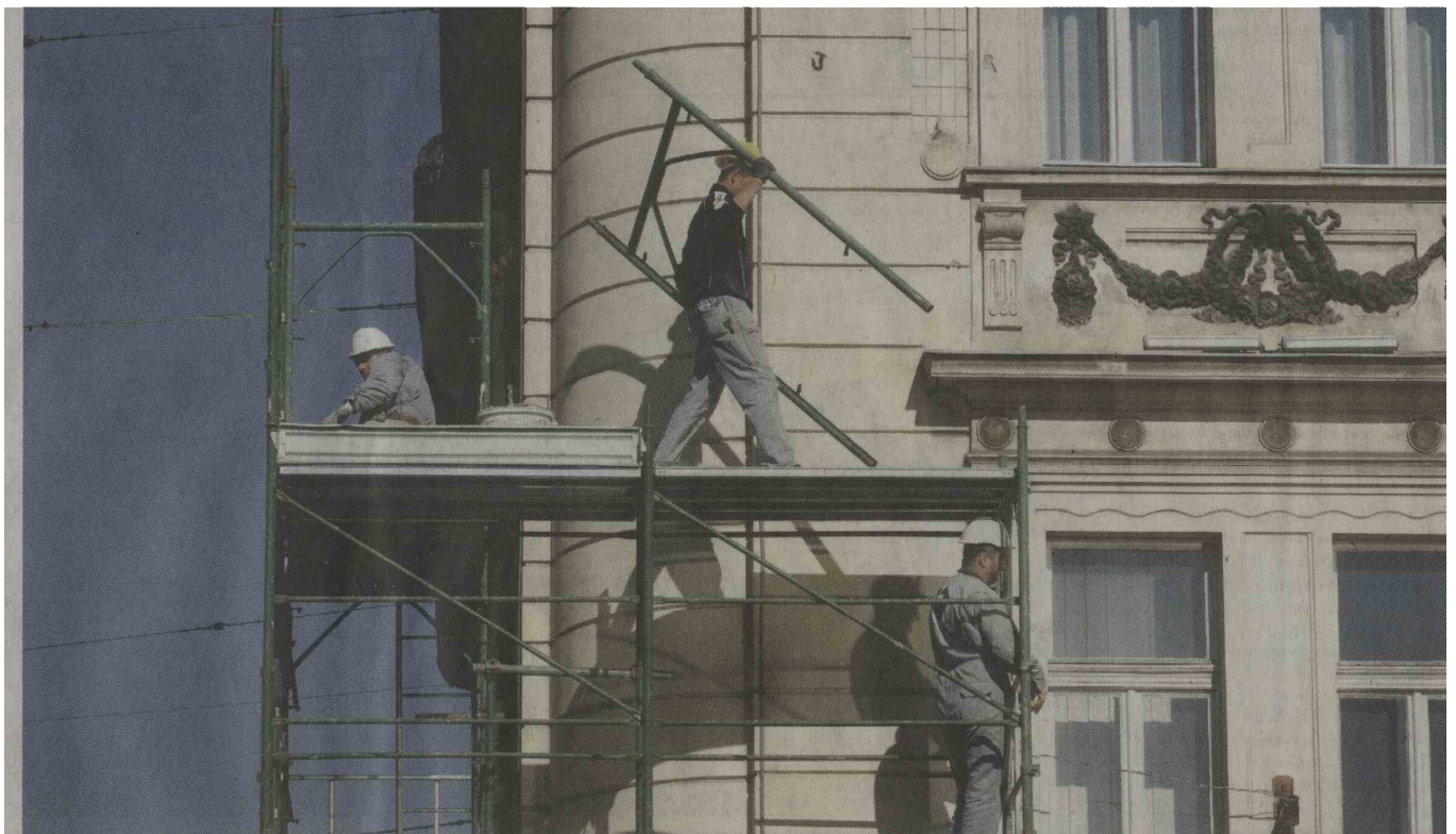
V Sloveniji imamo 80 odstotkov zelo potratnih stavb. FOTO BLAŽ SAMEC
