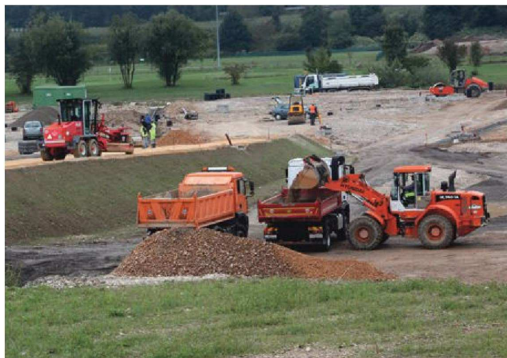
Semaforizirani priključek do P+R Stanežiče je že narejen, parkirišče pa bo dokončano do prihodnje pomladi. FOTO MAVRIC PIVK
