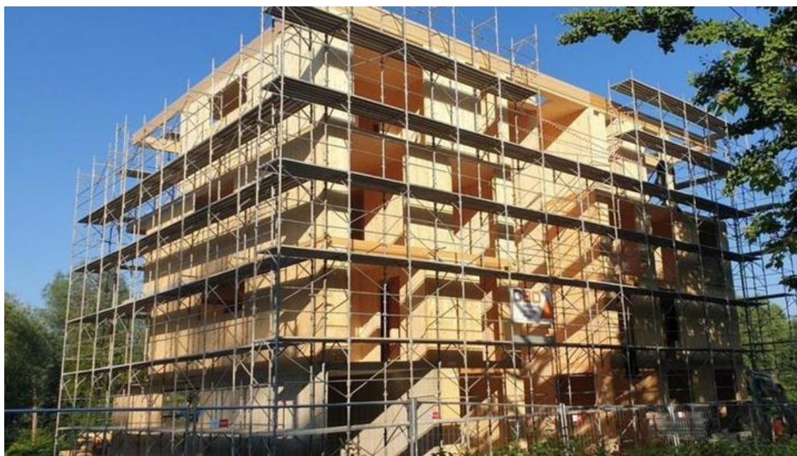
Štirietažni večstanovanjski vila blok v Rožni dolini gradijo v leseni masivni konstrukciji Xlam CLT.
