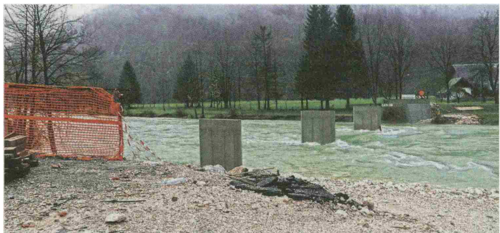
Novi nosilni stebri mostu v Logu pri Bitnjah v Bohinju ob visoki Savi Bohinjki v teh dneh
