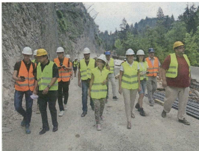
Na ogledu gradbišča galerije v Zali sta ministrica Alenka Bratušek in vodja projektov na Drsi Karmen Cian sporočili, da bodo cesto za promet polovično odprli 30. avgusta.
