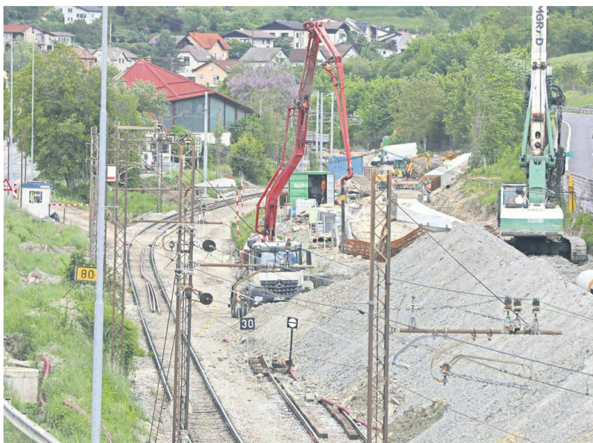
Izvedba del na železniški progi Maribor-Šentilj se je pričela v avgustu 2018 in se bo zaključila predvidoma v začetku 2020. Foto: Sašo BIZJAK
