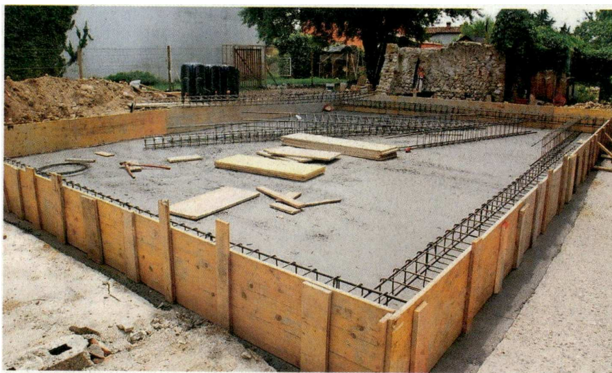
Pri izdelavi temeljne plošče za montažno hišo moramo biti zelo natančni. Foto: iStock
