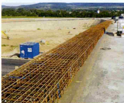
Seveda pa se lahko galvanska zaščita uporabi tudi preventivno, že pri izdelavi betonskih elementov oziroma objektov (uporaba anod Mapeshield I).
