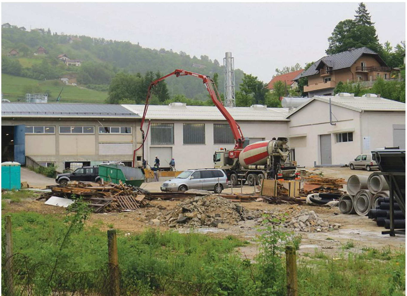
Gradbena inšpektorica zdaj, ko je objekt v obliki črke L že zgrajen, ugotavlja, da vse ni potekalo po črki zakona. FOTO BOJAN RAJŠEK
