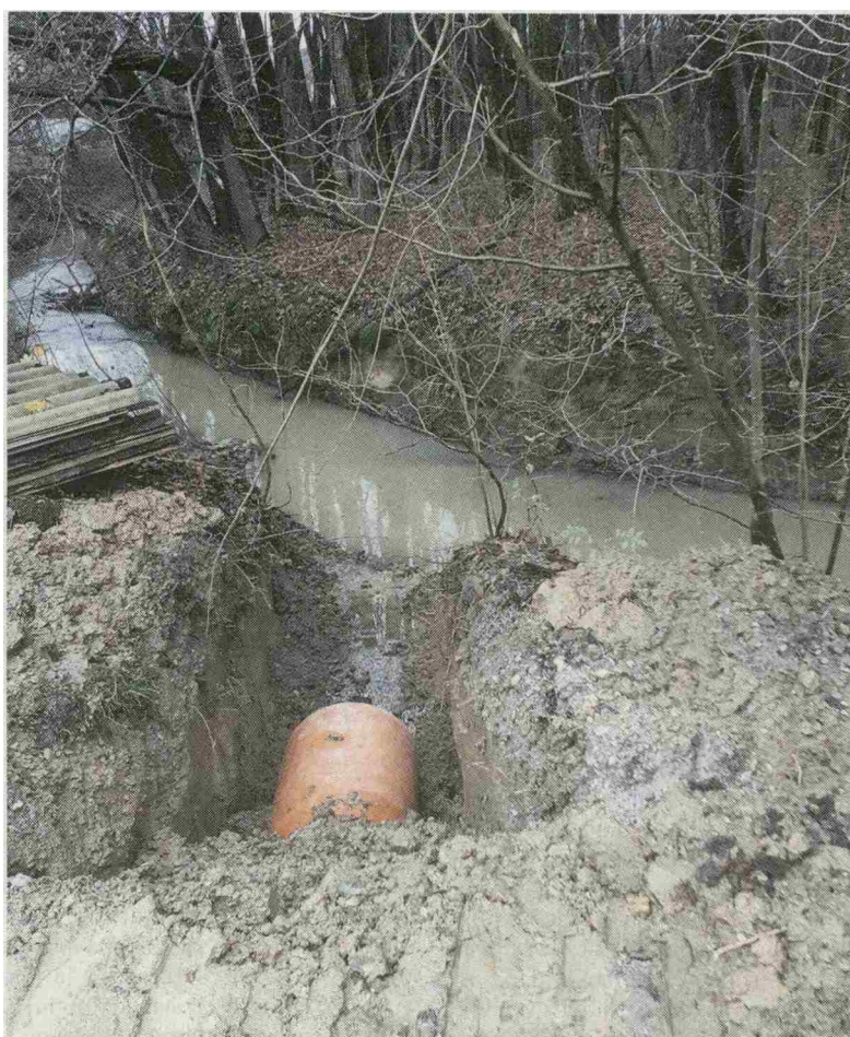
Iztočna cev meteorne kanalizacije je glede na dno potoka Lipnica, ki je v osnovi zelo plitek, položena globoko, kar pomeni, pravijo nekateri lastniki hiš v Levstikovi ulici, da potok ob visoki vodi ne bo mogel sprejemati padavinske vode. FOTOGRAFIJA MAJDA HORVAT
