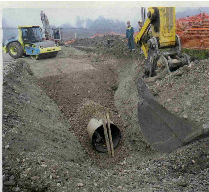
Nestrokovno polaganje cevi, zasipavanje in komprimiranje gradbenega jarka.
