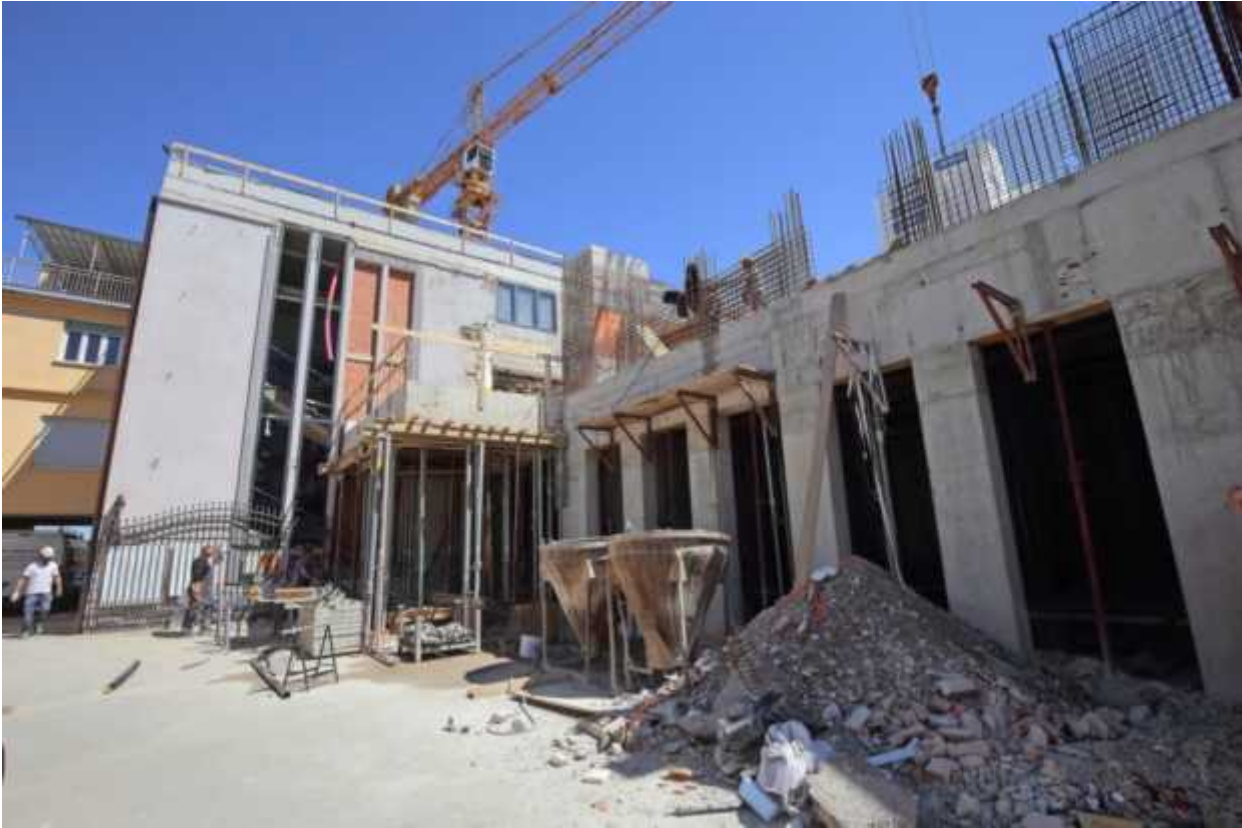
Obnova je v sklepni gradbeni fazi, delavci so začeli z obrtniški deli. (Foto: Zdravko Primožič/FPA)
