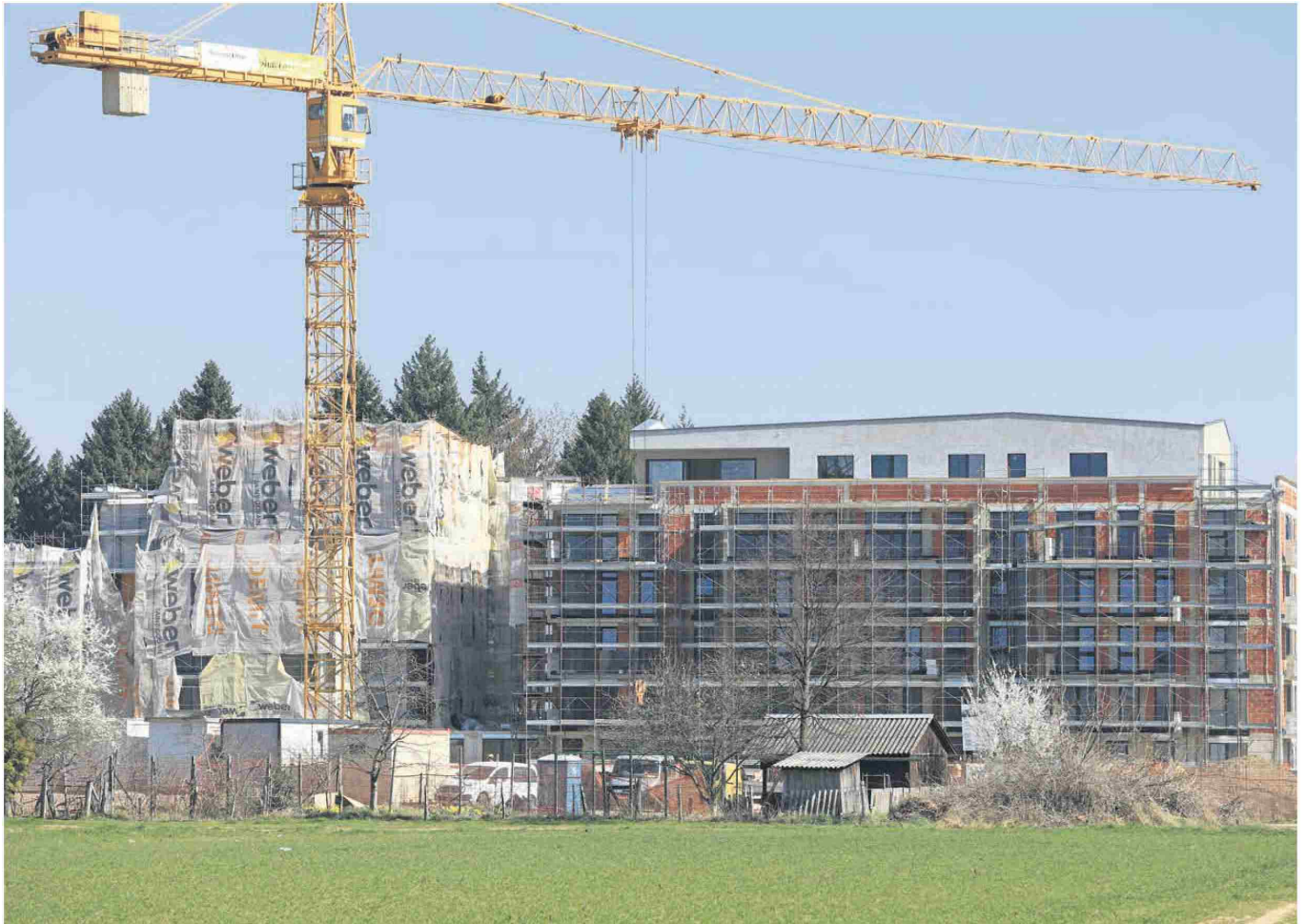
Gradnja blokovskega naselja v Engelsovi ulici, na meji med Taborom in Studenci, poteka normalno, v skladu z vladnimi smernicami. Foto: Andrej PETELINSEK
