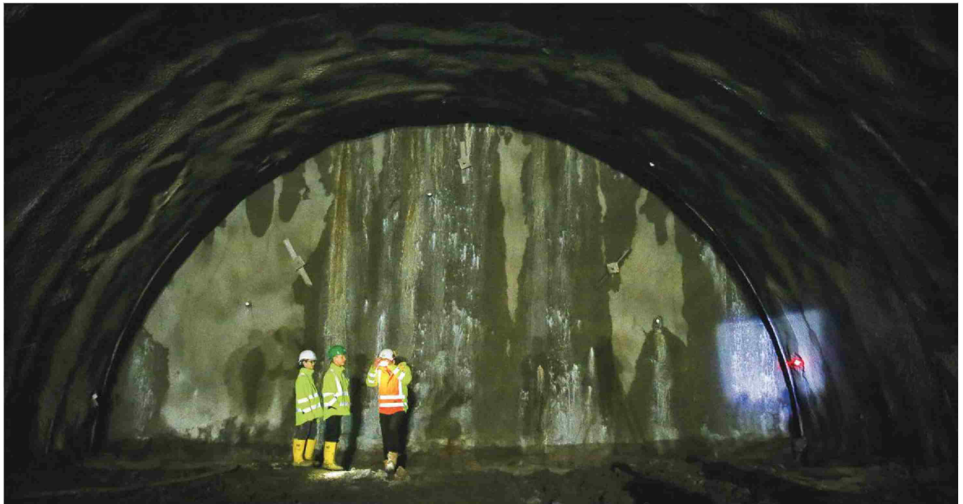
Avstrijski Swietelsky je pred desetimi dnevi ustavil vrtnanje karavanškega predora, Cengiz pa dela na predvkopu. FOTO JOŽE SUHADOLNIK
