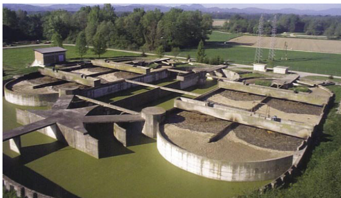
Slika 8 • Porušena in za več kot polovico zmanjšana zmogljivost zgrajene čistilne naprave brez denitrifikacije. Vgrajene propellerske črpalke so zamenjali s 4 aeracijskimi turbinami polovične zmogljivosti
