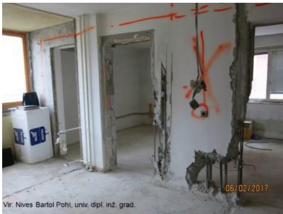
Slika 1 • Primer neustreznega posega v nosilno konstrukcijo večnadstropnega objekta v eni od spodnjih etaž.
