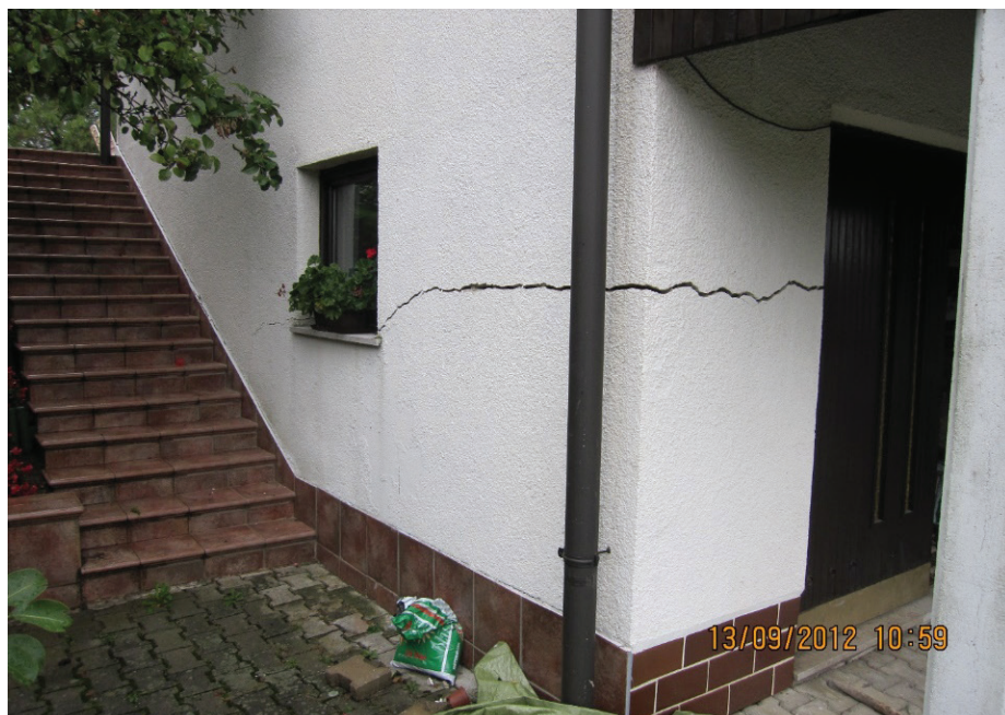
Slika 9 • Odpoved konstrukcije zaradi premikov tal.
