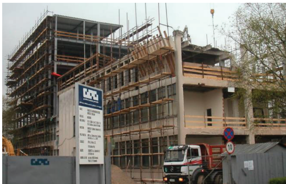
Slika 14 • Rekonstrukcija stavbe (Oddelek za matematiko, Fakultete za matematiko in fiziko Univerze v Ljubljani).
