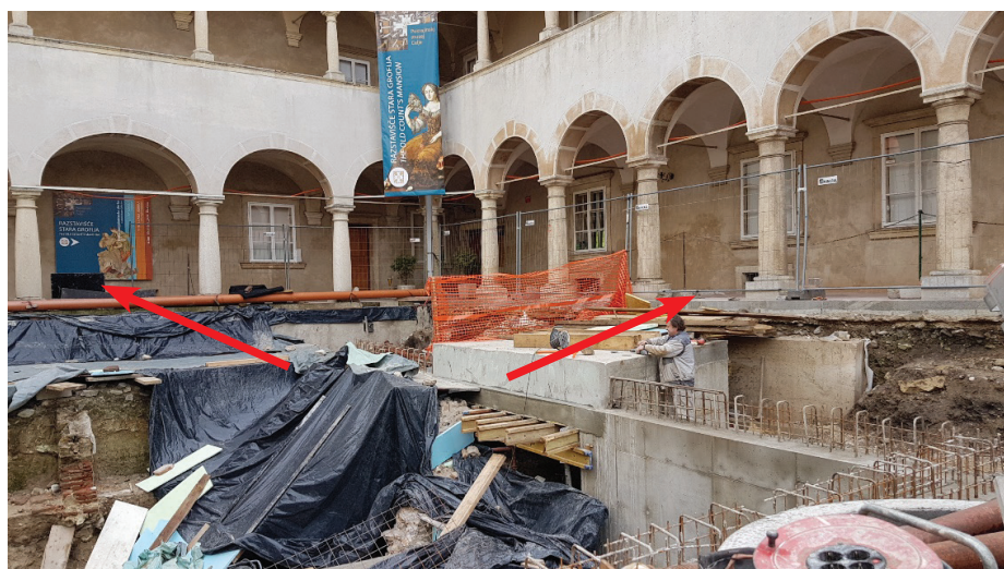
Slika 2 • Pogled na zahodni in severni arkadni hodnik zgradbe Stara grofija, gradbišče objekta za zaščito arheoloških ostalin, ter z rdečima puščicama nakazani smeri vzhodne in južne podzemne povezave.
