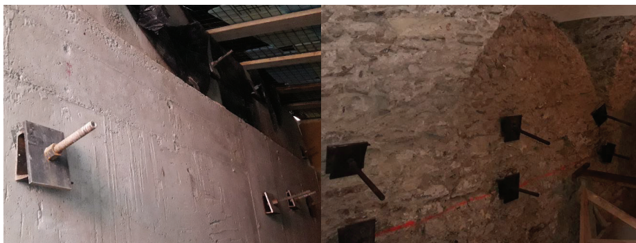
Slika 5 • Armiranobetonski varovalni gredi, izvedeni v dveh nivojih, povezani preko pasivnih sider z obstoječim kletnim zidovjem Stare grofije.
