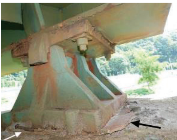
Slika 6 • Izpodrinjena svinčena plošča pod ležiščem in zračnost med strižnimi čepi Ø40 in ležiščem.
