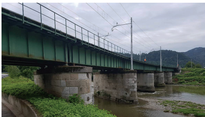
Slika 21 • Most pred sanacijo.
