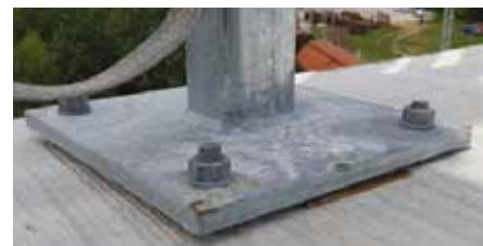
Slika 25 • Neustrezni jekljeni podložki in onemogočeno ustrezno podlivanje.
