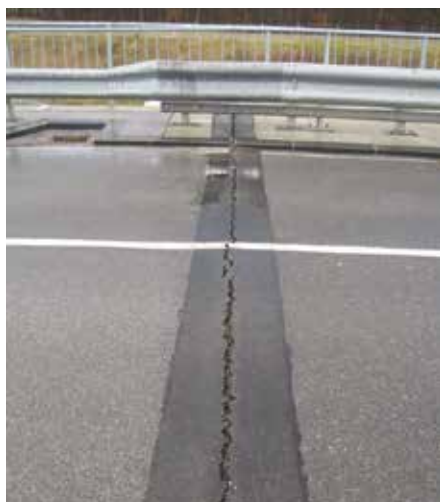
Slika 24 • Sredinska vzdolžna poškodba dilatacije.
