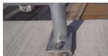
Slika 26 • Neustrezni jekljeni podložki in onemogočeno ustrezno podlivanje.
