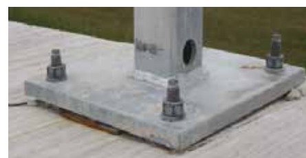
Slika 27 • Neustrezni jekljeni podložki in onemogočeno ustrezno podlivanje.
