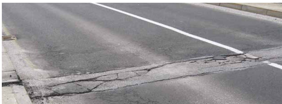
Slika 23 • Poškodba polnila dilatacije.
