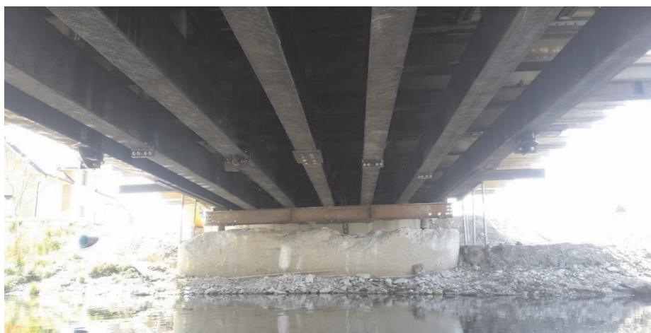
Slika 2 • Podporna konstrukcija mostu, na katerem smo opravljali meritve, iz jeklenih nosilcev HEB500
