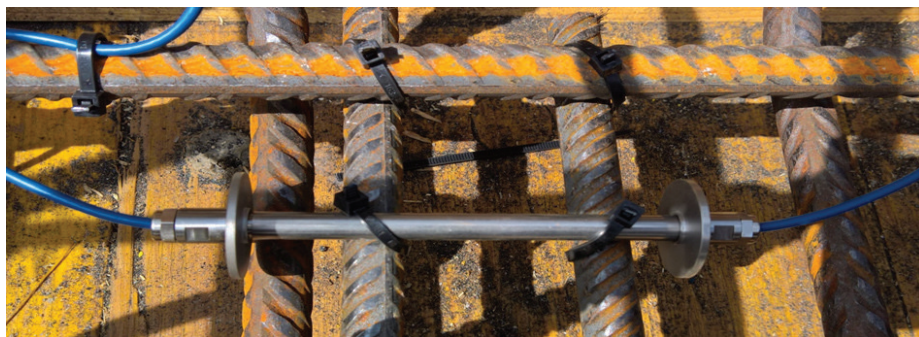
Slika 4 • Optični senzor za merjenje deformacij, ki smo ga namestili v spodnji coni konstrukcije na sredini razpona prekladne konstrukcije
