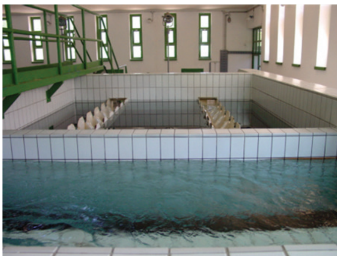
Slika 20 • Na lamelnem usedalniku peska očiščeni obrežni filtrat.
