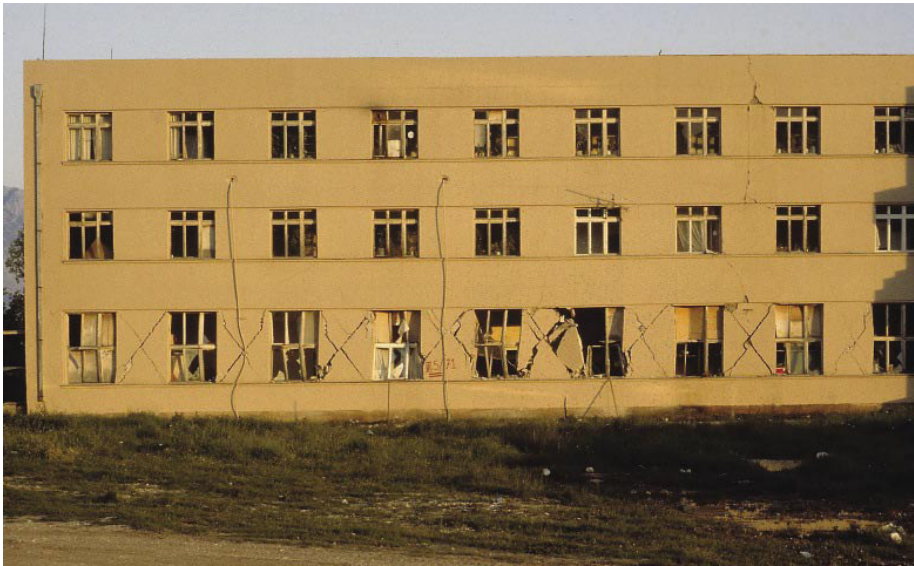
Slika 2 • Značilni etažni mehanizem s strižno porušitvijo zidov. Nearmirana opečna zidana stavba po potresu v Črni gori leta 1979 (Fotografija: M. Tomažević)
