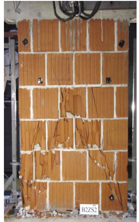
Slika 8 • Čeprav se je zid strižno porušil, so se v začetnih fazah preiskave zaradi njegovega vrtenja začeli drobiti zidaki v tlačnih vogalih (Tomaževič, 2012). (Fotografija: Arhiv ZAG)
