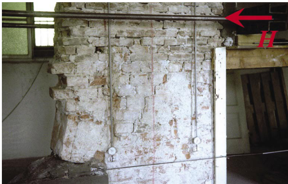
Slika 11 • Med terensko preiskavo opečnega zidu, preiskanega pri nizkih tlačnih napetostih, so nastale samo diagonalne razpoke. Slika prikazuje spodnjo polovico preiskanega zidu (Sheppard, 1985). (Fotografija: Arhiv ZAG)
