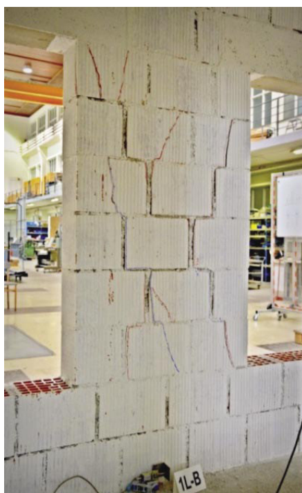
Slika 12 • Med preiskavo trietažne strižne stene ni bilo opaziti znakov vrtenja osrednjega zidu. Slika kaže poškodbe, nastale pri etažnem zasuku v velikosti 0,25 % etažne višine, že po doseženi maksimalni odpornosti (Triller, 2016). (Fotografija: Arhiv ZAG)
