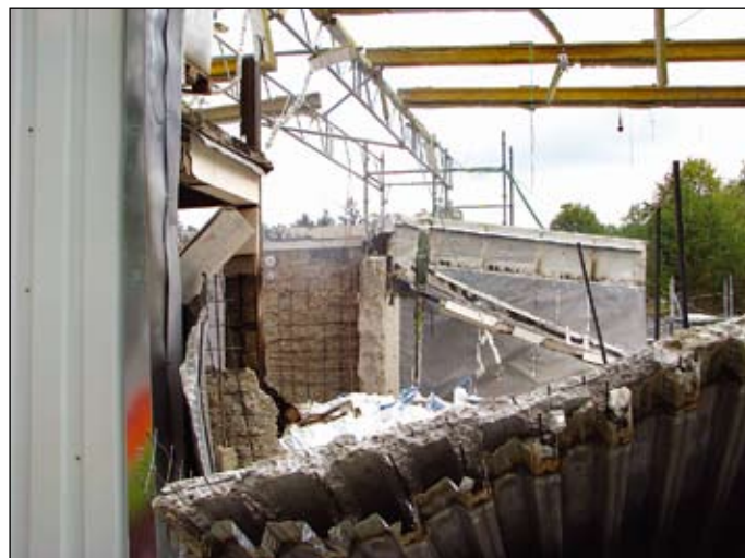
Požarni preskus v naravnem merilu je pokazal, da bi prišlo do porušitve betonske plošče, armirane z jekleno pločevino (sistem HI Bond) in dodatno armaturo, prej kot v 90 minutah, če stropna plošča ne bi bila dodatno požarno zaščiten. V ozadju lepo vidna armatura stene, ki je po požaru ostala popolnoma nezaščiten zaradi eksplozijskega odpadanja betona (foto Milan Hajduković).
