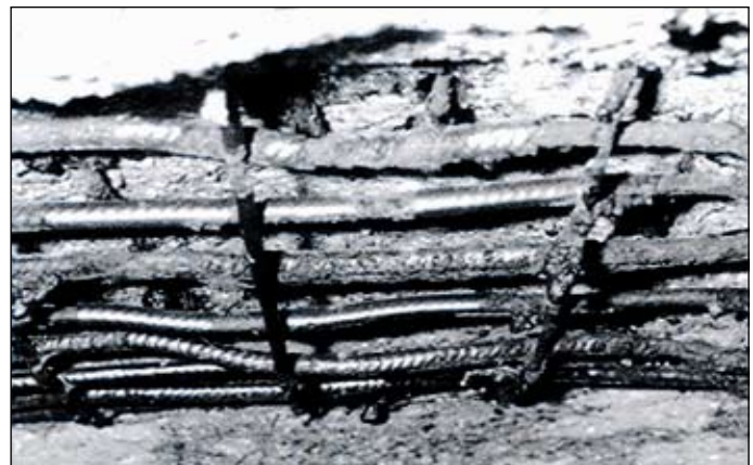
Po požaru; odpadanje betona tudi do 40 cm globoko
