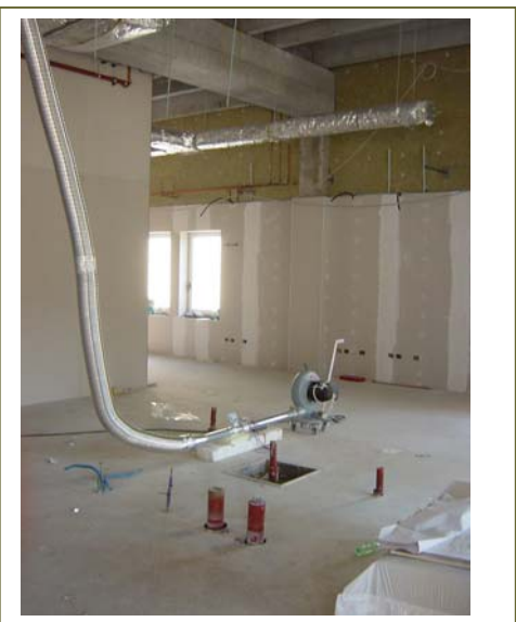
Slika 6: Primer merilne proge z ventilatorjem in zvijavo zračno cevjo.
