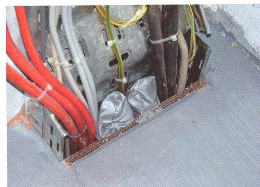
Slika 2: Neustrezna izvedba požarne zaščite prehoda električnih inštalacij skozi mejo požarnega sektorja - ustreznost izvedbe je bila potrjena v izkazu požarne varnosti
