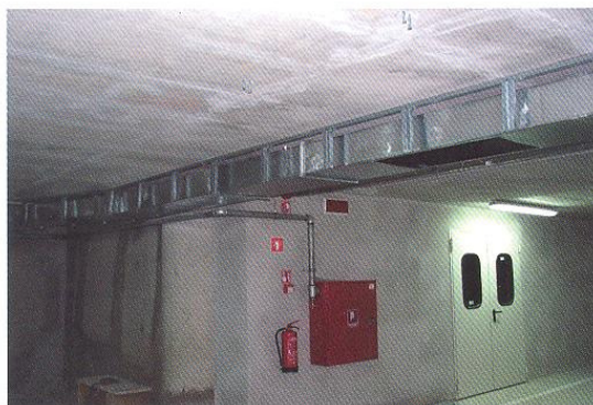
Slika 5: Nepravilna izvedba požarno odpornega večsektorskega kanala za odvod dima in toplote, ki bi moral zagotavljati temperaturno odpornost 400 °C - običajen pločevinast kanal so z zunanje strani zaščitili z mavčno kartonsko oblogo - stanje na tehničnem pregledu
