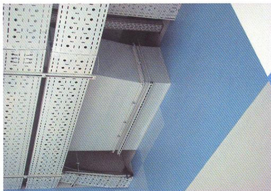
Slika 4: Nezaščiteni prehodi inštalacij skozi mejo požarnega sektorja - stanje na tehničnem pregledu
