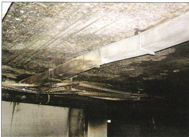
Požarno odporen strop podzemne garaže po požaru – REI 90? (vir: Leon Pajek)
