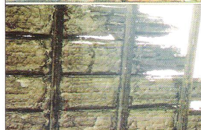
Požar na strehi iz poliuretana (Brandschutzatlas, FeuerTRUTZ)
