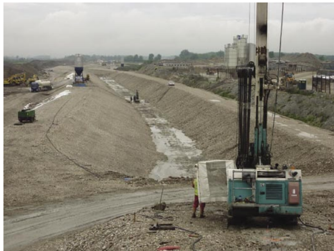
Slika 4 • Gradnja nasipov bazena se je v polnem zagonu. Na sliki je spodnji del nasipa pri jezovni zgradbi HE Brežice, ki je v zgodnji fazi gradnje sestavljen iz dveh delov, med katerima se izvaja tesnitev podlage s tesnilno zaveso
