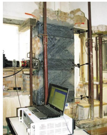
Slika 30 • Terenska preiskava učinka utrditve opečnega zidu s CFRP-tkanino (Fotografija: Arhiv ZAG)
