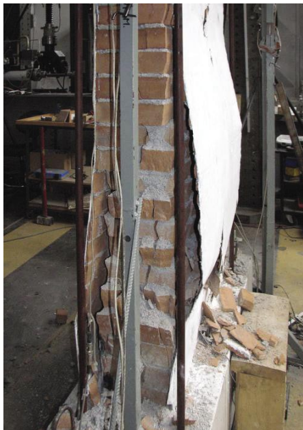
Slika 28 • Izbočenje obloge opečnega zidu, armirane s tkanino iz s steklenimi vlakni ojačenih polimerov v epoksidni matriki, pri porušitvi (Fotografija: M. Tomažević)
