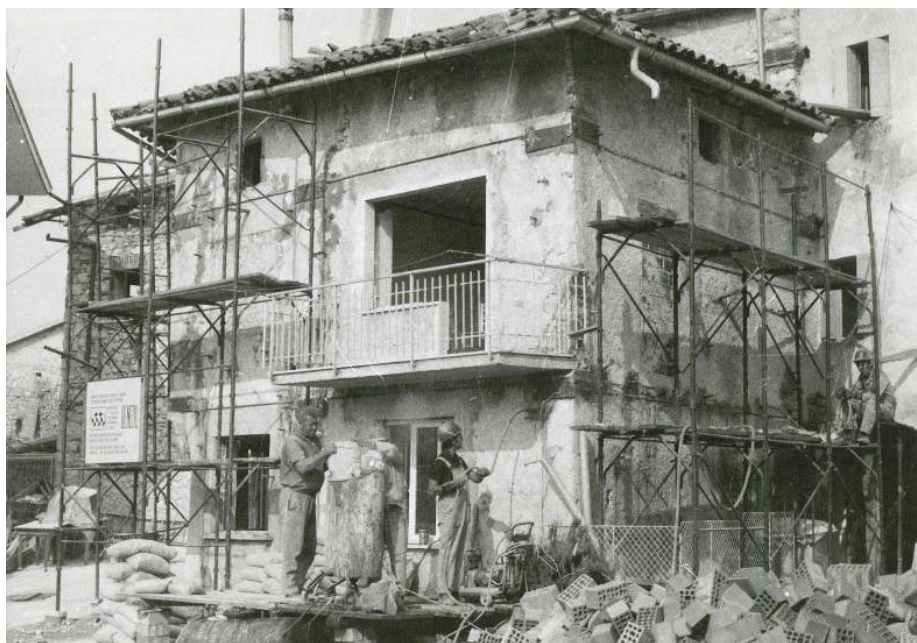
Slika 4 • Hiša, ki jo je po majskem potresu leta 1976 v Benečiji utrdila ekipa ZRMK, je septembrski potres istega leta prestala brez poškodb. (Fotografija: E. Vugrinec)
